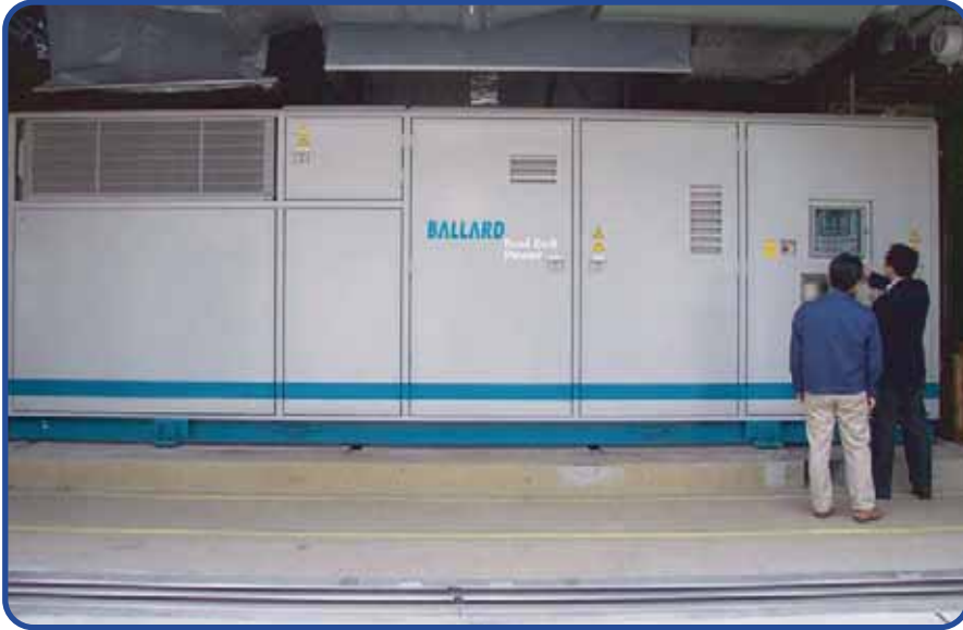
フィールドテスト中の 250kW定置型PEFC (NTT)
